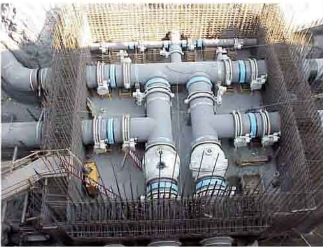
泵房进出口管道: 方便泵房阀门的维修，并起到膨胀及减震的作用。
